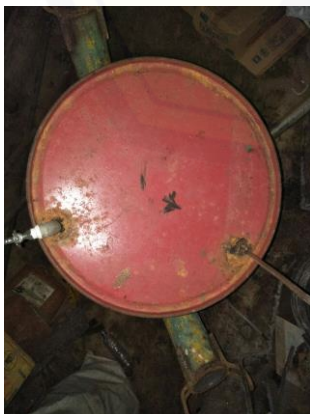
Gambar 1. Digester tampak atas
