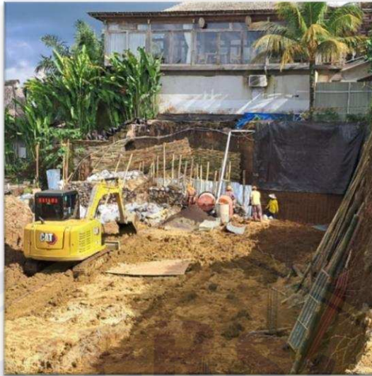
Gambar 4. 6 Kondisi DPT Eksisting Pasca Longsor
