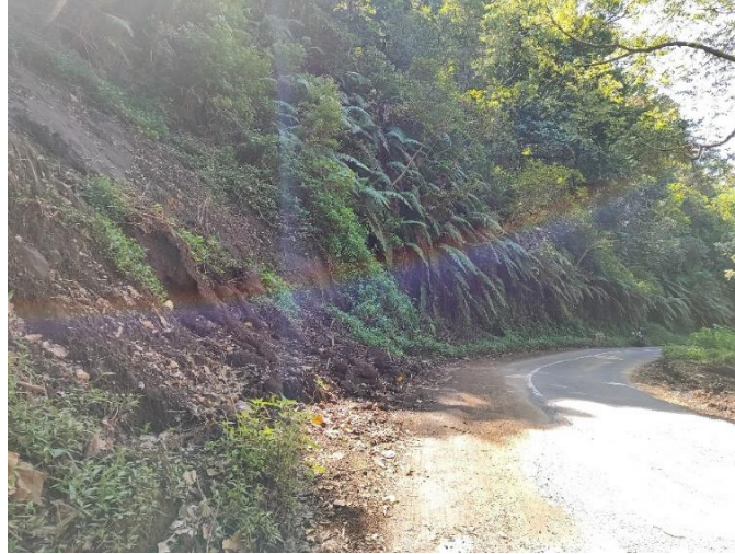
Gambar 1. 1 Longsoran di jalan akses wisata Kawah Ijen
