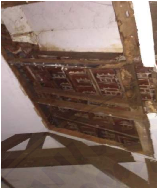
Kondisi kayu ring pada kampus 1
