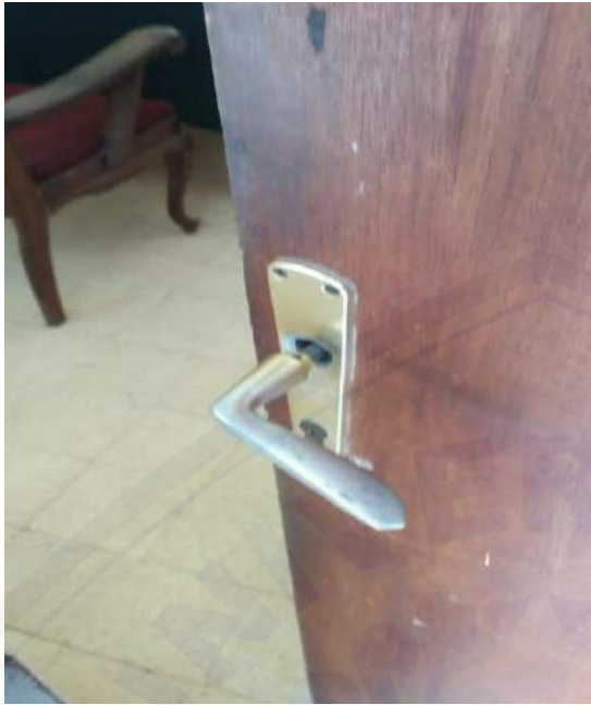
Kondisi kunci pintu yang mengalami kerusakan
