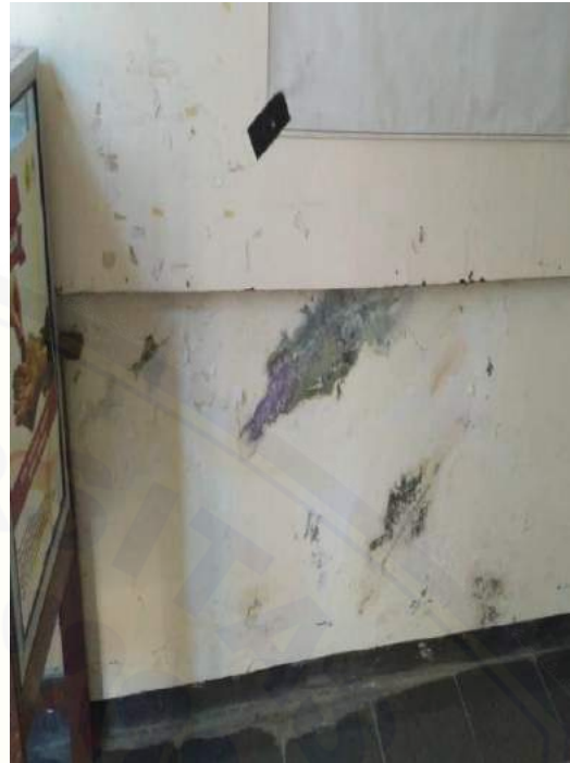
Kondisi Kerusakan Cat Dinding pada gedung A kampus III
