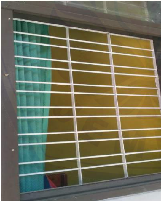
Kondisi Kerusakan Daun jendela pada kampus 1
