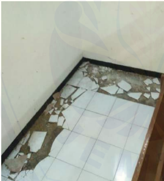
Kondisi Keramik pada kampus 3 gedung B
