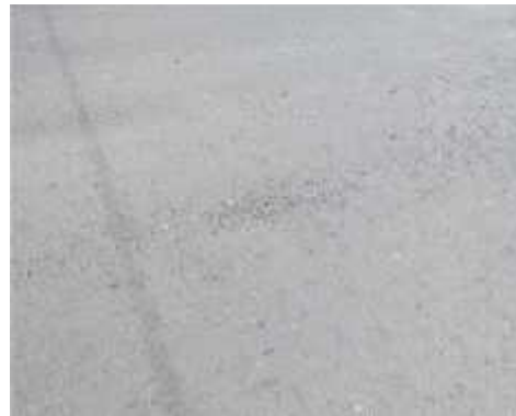
4. Kerusakan Pelapukan Butiran
