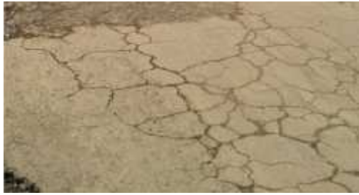
Gambar 2.3 Retak Kulit Buaya ( alligator crack ) (Sumber : Sumantri, 2015)
