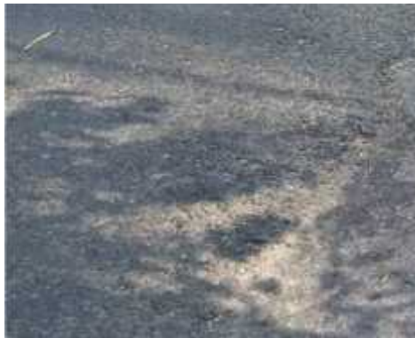
3. Kerusakan Pelapukan Butiran
