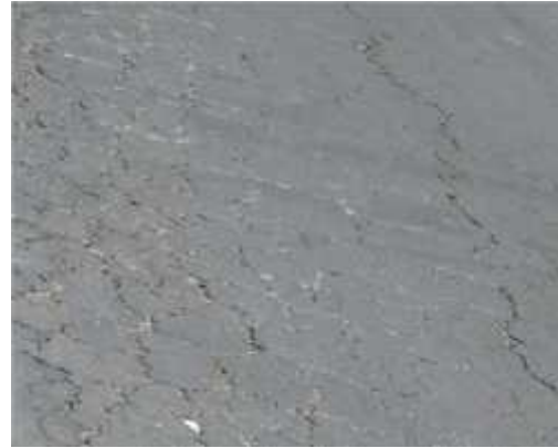
8. Kerusakan Retak Kulit Buaya
