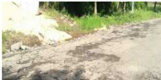
Gambar 2.4 Retak pinggir ( edge crack ) (Sumber : Sumantri, 2015)
