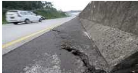
Gambar 2.7 Retak sambungan pelebaran jalan ( widening cracks ) (Sumber : Sumantri, 2015)
