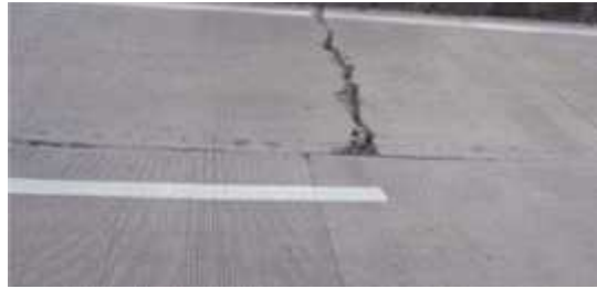
Gambar 2.5 Retak sambungan bahu dan perkerasan ( edge joint crack ) (Sumber : Sumantri, 2015)
