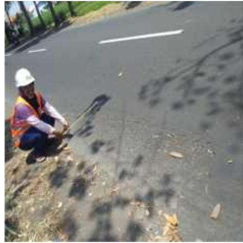
2. Pengukuran Kerusakan jalan
