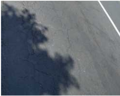
7. Kerusakan Retak Kulit Buaya
