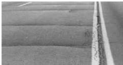
Gambar 2.8 Retak refleksi ( reflection cracks ) (Sumber : Sumantri, 2015)
