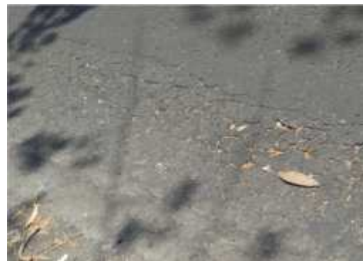
10. Kerusakan Retak Kulit Buaya
