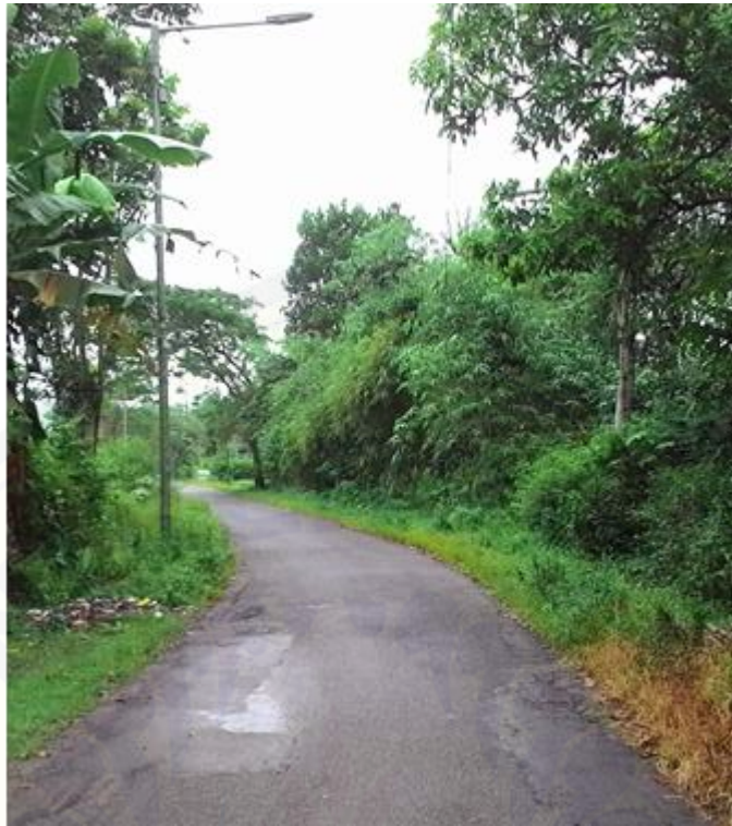
Gambar 3.1 Kondisi eksisting jalan lama
