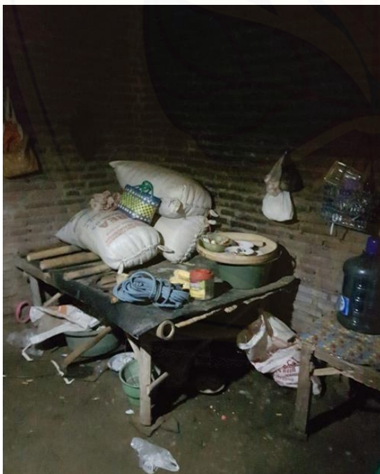
Kondisi kelembapan rumah responden
