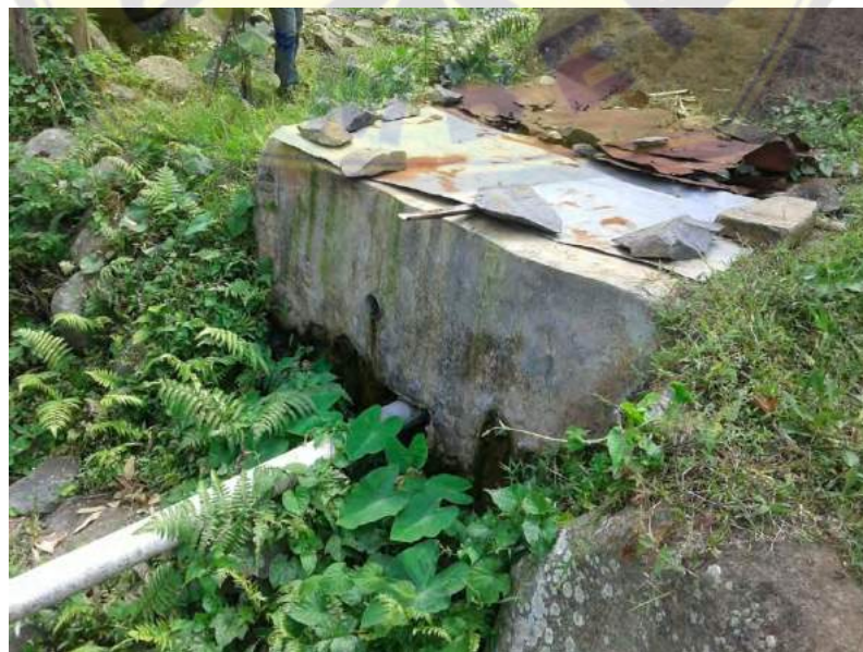
Gambar L.3.4 Kondisi Bangunan Broundkap Gading
