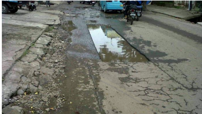
Gambar 2.10 Retak sambungan bahu dan perkerasan ( edge joint crack )
