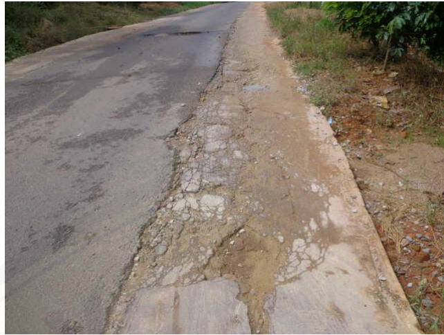
Gambar 2.12 Retak sambungan pelebaran jalan ( widening cracks )
