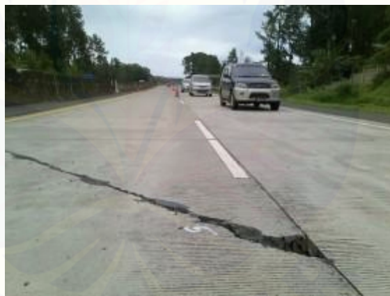
Gambar 2.11 Retak Sambungan Jalan
