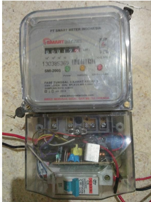
KWH Meter yang terpasang relay pemutus
