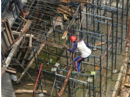
Substandard action yang dilakukan oleh responden saat melakukan pemasangan scaffolding
