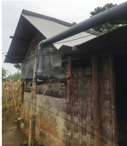
Gambar 4. 21 Talang sebagai media tadah hujan
