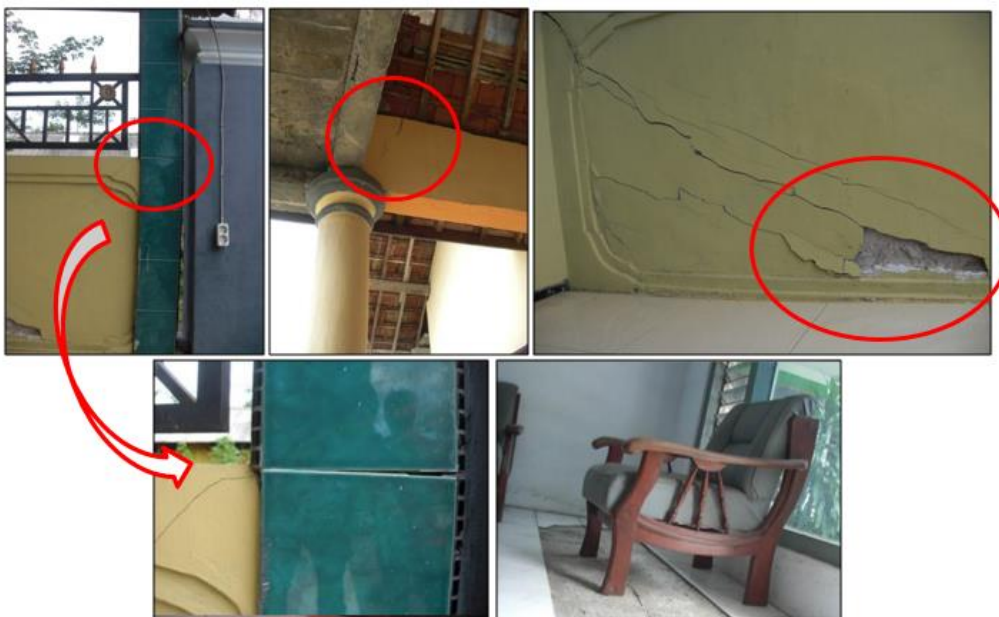
Gambar 3. Dokumentasi kerusakan rumah warga
