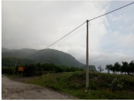
Gambar 4. 22 Jaringan Listrik 1 (Sumber: Survei primer 2022)
