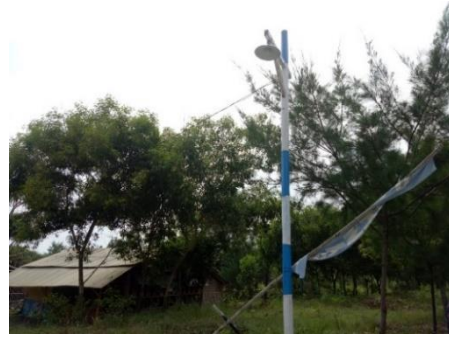
Gambar 4. 23 Jaringan Listrik 2 (Sumber: Survei Primer 2022)
