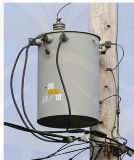
Gambar 2.3 Trafo Distribusi Pada Sistem Distribusi (Diakses 20 Juni 2020)
