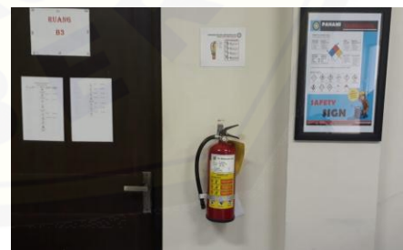
Gambar 12. Terdapat alat pemadam kebakaran dan tempat sampah
