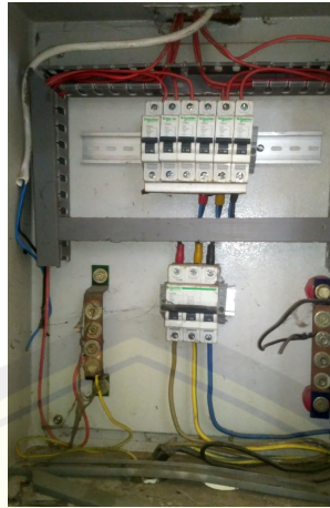
Gambar 3.5 Panel Beban Penerangan dan Kotak Kontak Lantai 3
