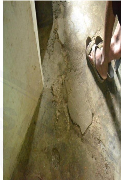
j. Kondisi lantai rumah yang diplester dan berdebu
