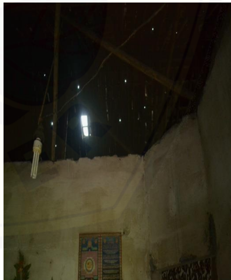
d. Kondisi rumah dengan tidak ada langit-langit dan dengan kondisi yang kotor dan rawan kecelakaan
