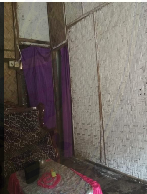
h.Kondisi dinding rumah dengan lantai tanah dan dinding berupa anyaman bambu (2)
