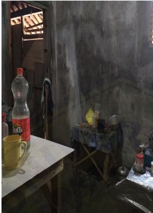
m. Kondisi dapur dengan ventilasi yang kurang
