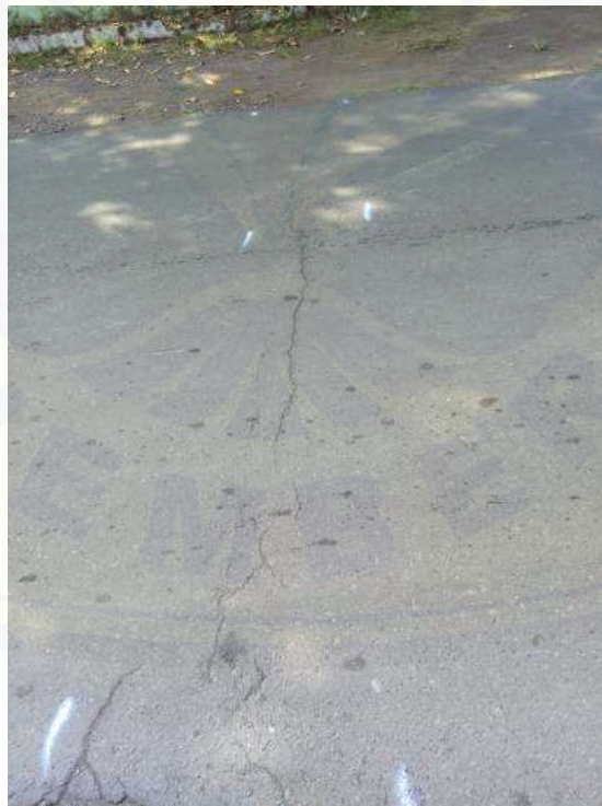
D.4 Jenis Kerusakan Retak Memanjang dan Melintang
