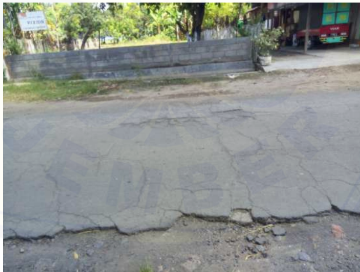
Gambar 2.4 Retak Blok ( block cracking ) (Sumber: Dokumentasi, 2017)
