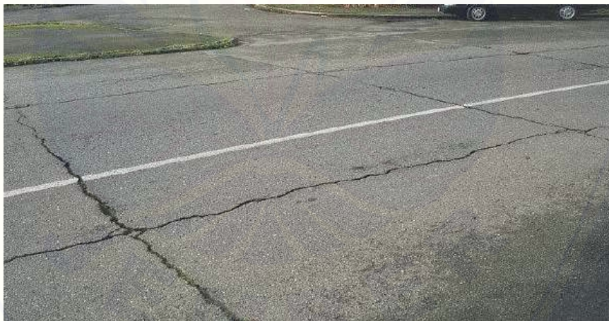
Gambar 2.9 Retak Refleksi Sambungan ( joint reflection cracking ) (Sumber: Google Image, 2017)
