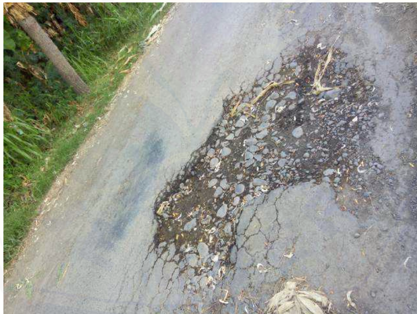
D.12 Jenis Kerusakan Lubang
