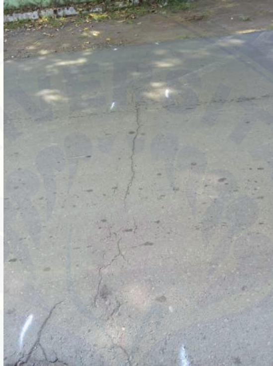
Gambar 2.11 Retak Melintang ( transverse cracking ) (Sumber: Dokumentasi, 2017)
