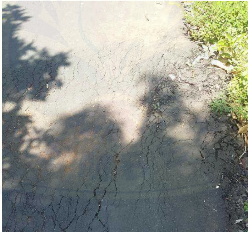
D.14 Jenis Kerusakan Jembul
