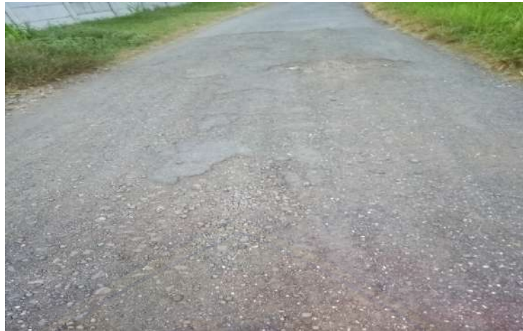
Gambar 2.10 Pelapukan dan Butiran Lepas ( weathering and raveling ) (Sumber: Dokumentasi, 2017)
