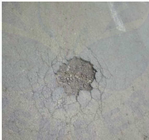
Gambar 2.14 Lubang ( pothole ) (Sumber: Dokumentasi, 2017)
