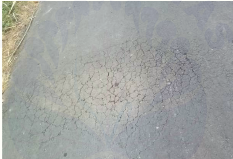
Gambar 2.2 Retak Kulit Buaya (Sumber: Dokumentasi, 2017)
