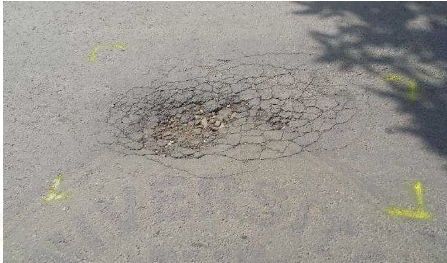
D.13 Jenis Kerusakan Ambles
