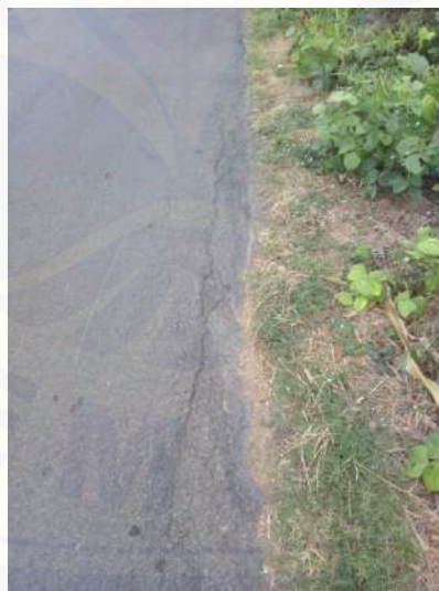
Gambar 2.8 Retak Pinggir ( edge cracking ) (Sumber: Dokumentasi, 2017)
