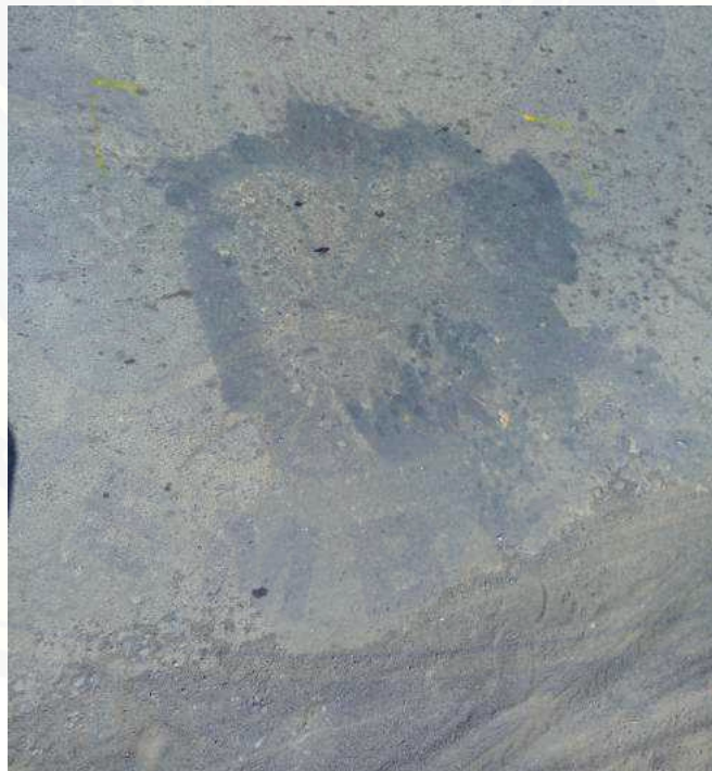
D.6 Jenis Kerusakan Tambalan
