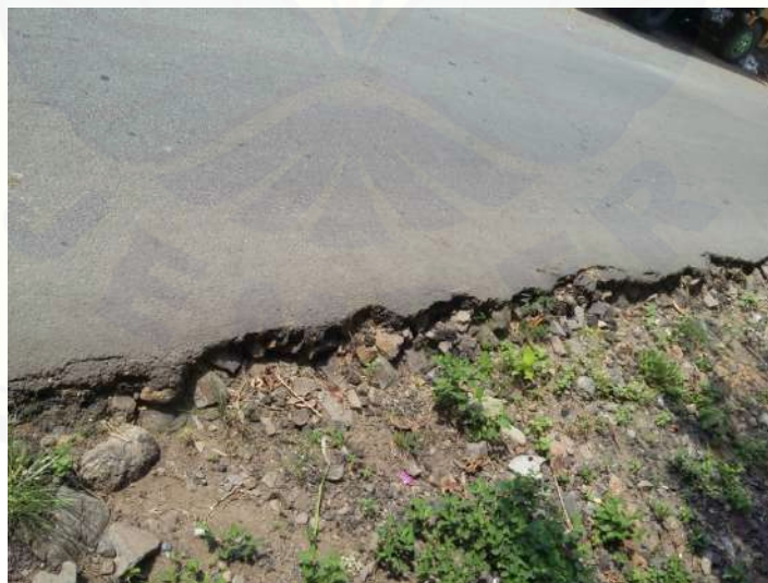
Gambar 2.20 Jalur atau Bahu Turun ( lane/shoulder drop-off )
