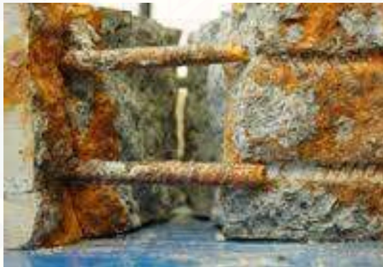
Gambar 2.1 Korosi pada Kerangka Bangunan
