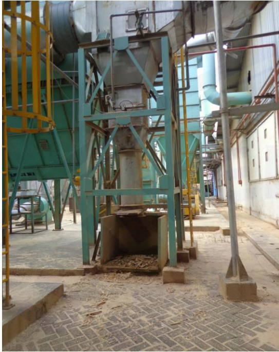
Gambar 4.5 Mesin Bag Filter sebelum dilakukan pembersihan
