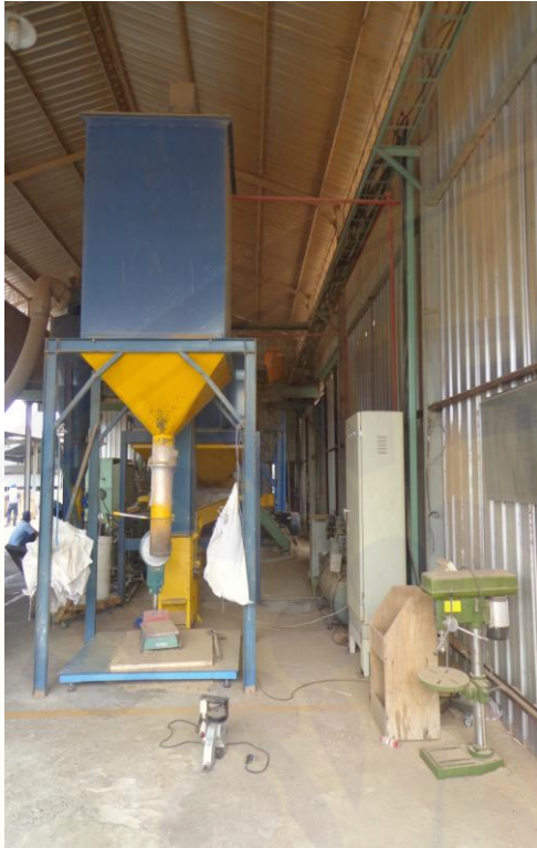
Gambar 4.4 Kondisi Letak Kabel pada Mesin Pellet yang Kurang Tepat
