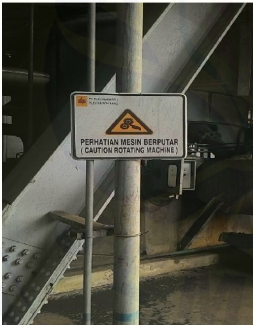
Gambar 3. Papan Peringatan Tanda Bahaya di Mill Boiler
