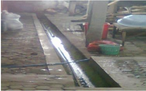
Gambar 4.32a Saluran air limbah yang tidak tertutup
