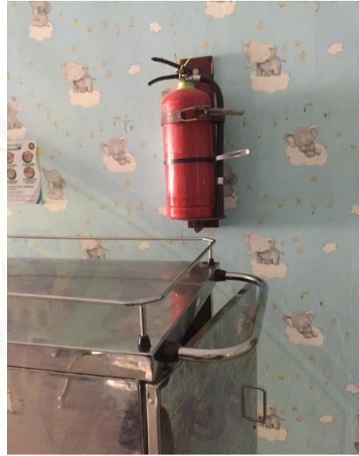
Pemasangan APAR yang tidak lengkap, tidak terdapat label, tanda pemasangan dan keterangan petunjuk penggunaan
