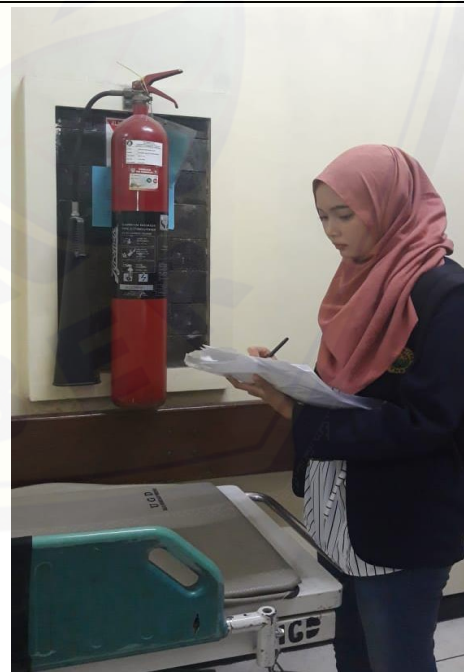
Pemasangan APAR yang terlalu tinggi dan terhalangi. Petunjuk penggunaan APAR juga terhalang oleh APAR
